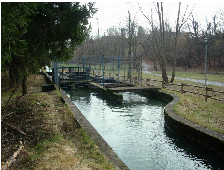
Figura 14 - Manufatto partitore sul canale del Cosa
