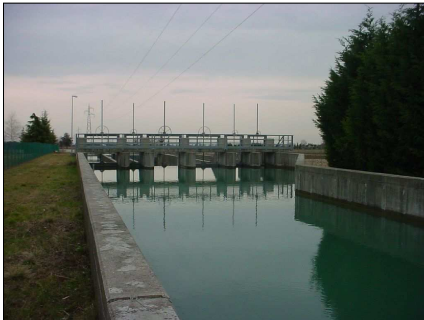
Figura 8 - Manufatti partitori alla presa del Giulio
