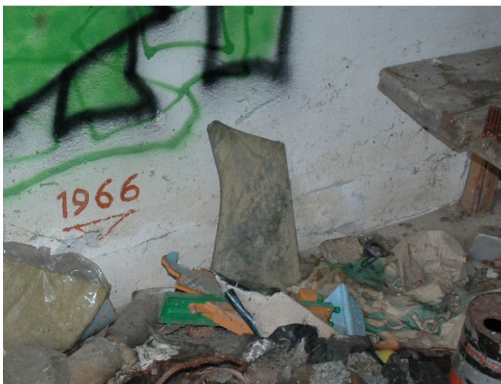
Figura 6.10.4: livelli massimi raggiunti dalla piena del 1966, 25 cm dal pavimento
