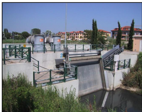
Idrovora Rotta Primero (Grado)
