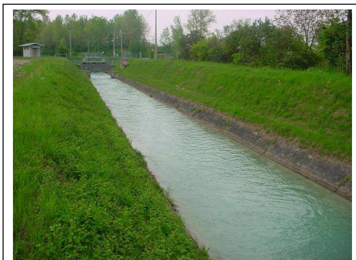
Figura 101 - Consorzio di bonifica Cellina Meduna: canale principale di Villa Rinaldi che alimenta i comizi irrigui a scorrimento nella zona nord di Pordenone compresa tra l'abitato di Cordenons e Fontanafredda
