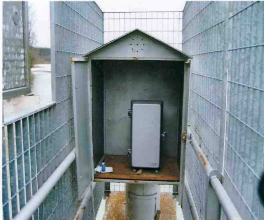
IDROMETROGRAFO SIAP INSTALLATO IN CABINA
