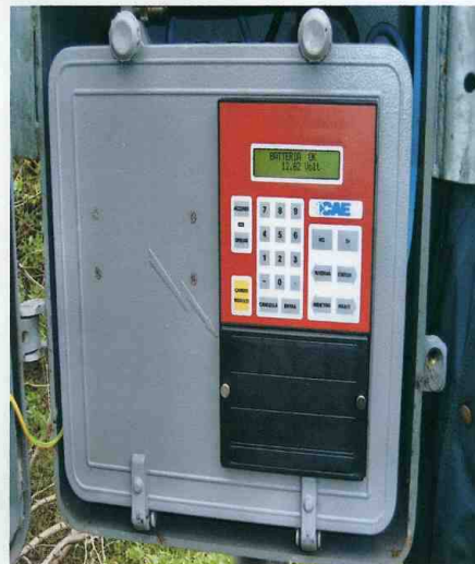
DETTAGLIO PANNELLO DI CONTROLLO
