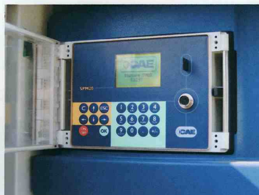
DETTAGLIO PANNELLO DI CONTROLLO
