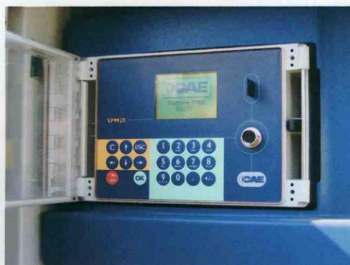
DETTAGLIO PANNELLO DI CONTROLLO
