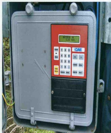
DETTAGLIO PANNELLO DI CONTROLLO
