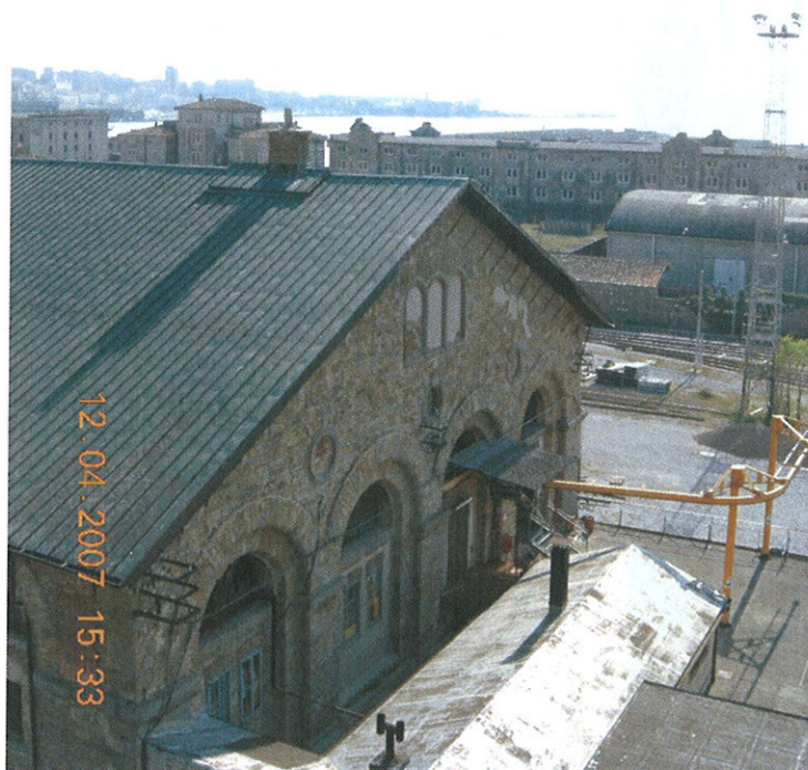
Foto 4: Manica est dei Silos – Testata nord verso RFI, terrazzo con superfetazioni di epoca recente
