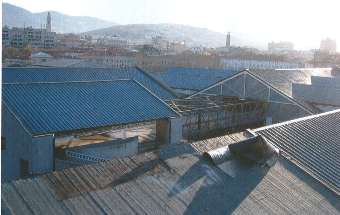
Foto 13: Collegamenti e copertura del corpo rampe autosilo e della testata a tre falde, dalla copertura dell'ala ovest
