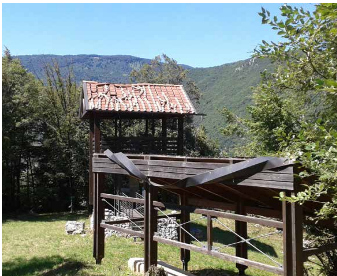
5. La torre con la copertura messa in opera in anni recenti che necessita di lavori di ripristino.
