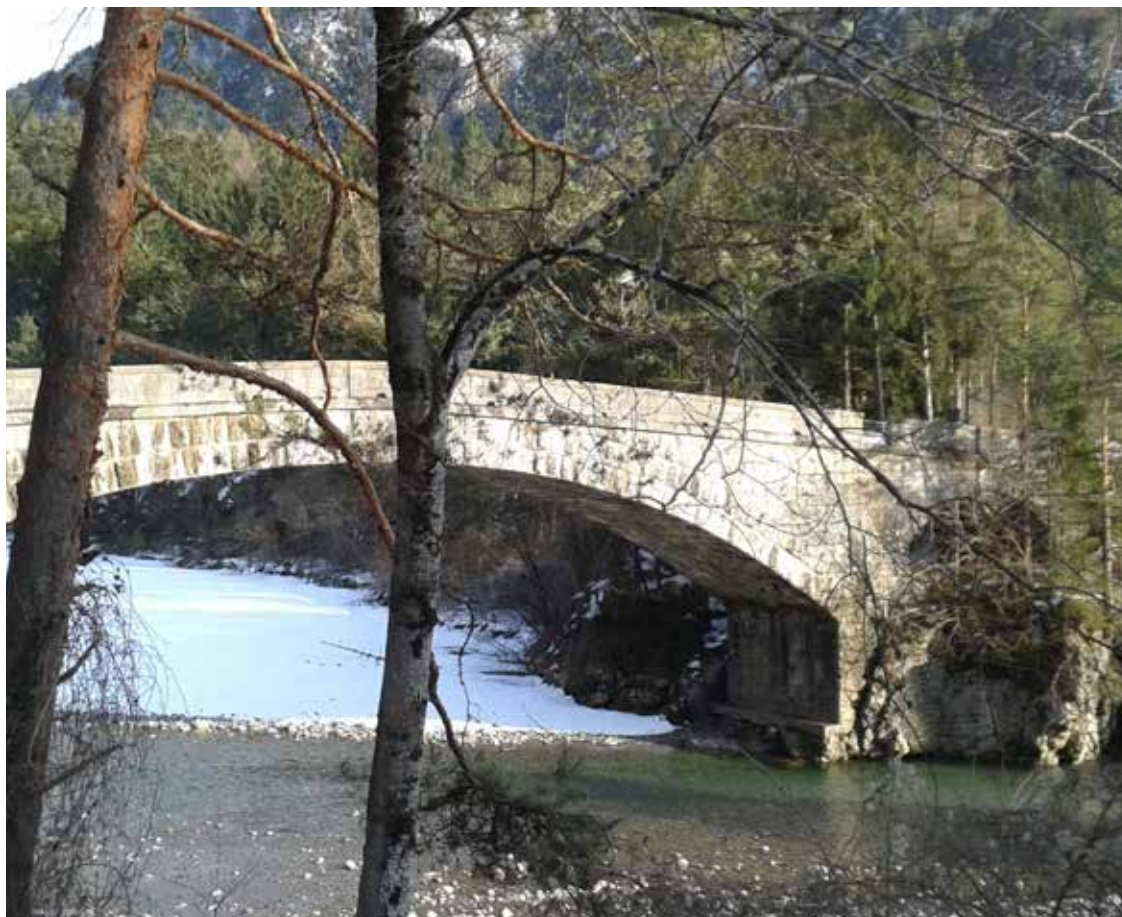
2. Il ponte che consente l'attraversamento del Fiume Tagliamento in direzione di Verzegnis.
