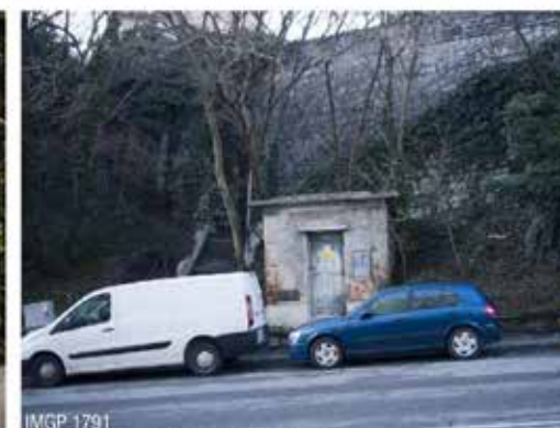
IMGP 1791 Cabina elettrica servizi pubblici degradata.
